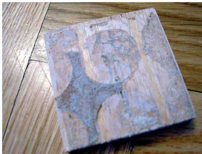
Spoina klejowa uległa degradacji nawet na warstwie papieru perforowanego.
