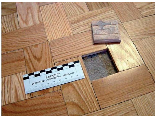
Wyraźnie odspojona powierzchnia klejowa
