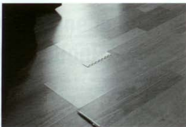
Zdj. 1. Uwydatnione przez wilgoć krawędzie elementów.
