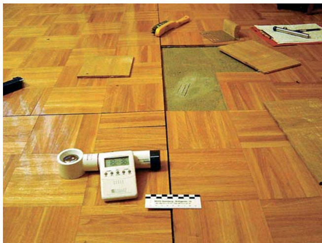
Wyraznie widoczne staranne klejenie całej powierzchni. W tym przypadku klej zamienił się w proszek
