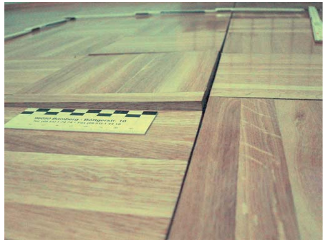
Całość mozaiki odspojona
